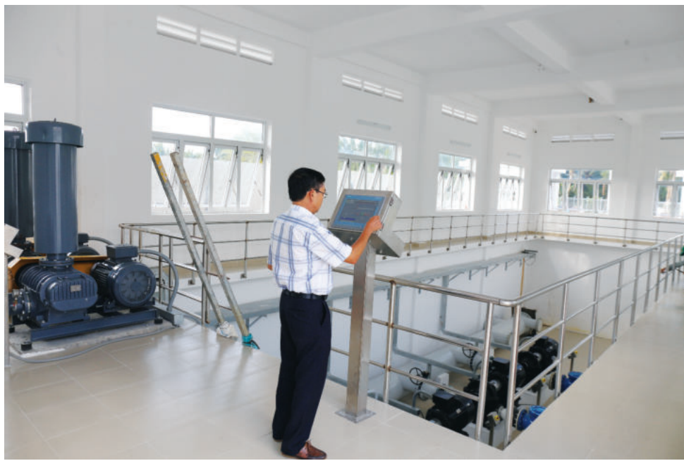
Dây chuyền sản xuất của nhà máy được vận hành hoàn toàn tự động nhờ Hệ thống Scada, giúp kiểm soát hiệu quả và tối ưu hóa quy trình vận hành
