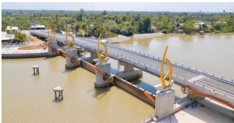
Cống ngăn mặn Bông Bót (xã An Phú Tân, huyện Cầu Kè), giải pháp bền vững để ứng phó với tình trạng xâm nhập mặn tại Đồng bằng sông Cửu Long
