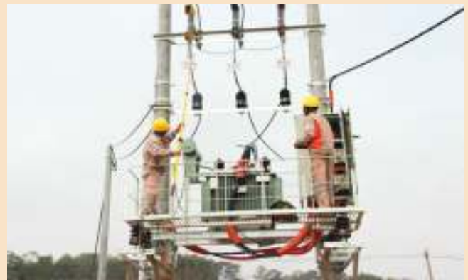
Cán bộ của PC Bắc Giang kiểm tra hệ thống lưới điện nhằm đảm bảo cung cấp điện ổn định, an toàn
