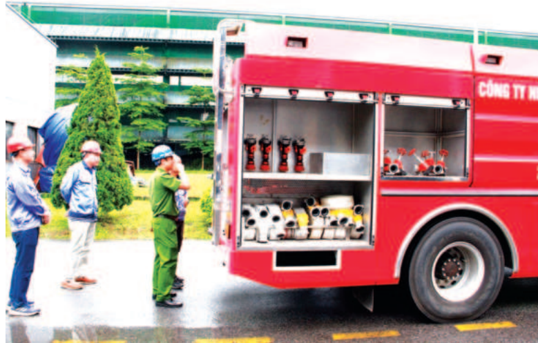
Cán bộ Phòng Cảnh sát PCCC&CNCH, Công an tỉnh Thái Nguyên kiểm tra hệ thống phương tiện PCCC tại Công ty Nhiệt điện Cao Ngạn - TKV
